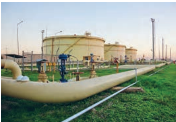
شکل ۲۱- نمایی از خطوط انتقال سوخت
